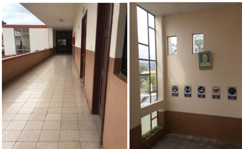
Figura 2. Inspección a la Unidad Educativa "Sagrados Corazones", no se encontró anomalías en su estructura. Ciudad de Cuenca.
